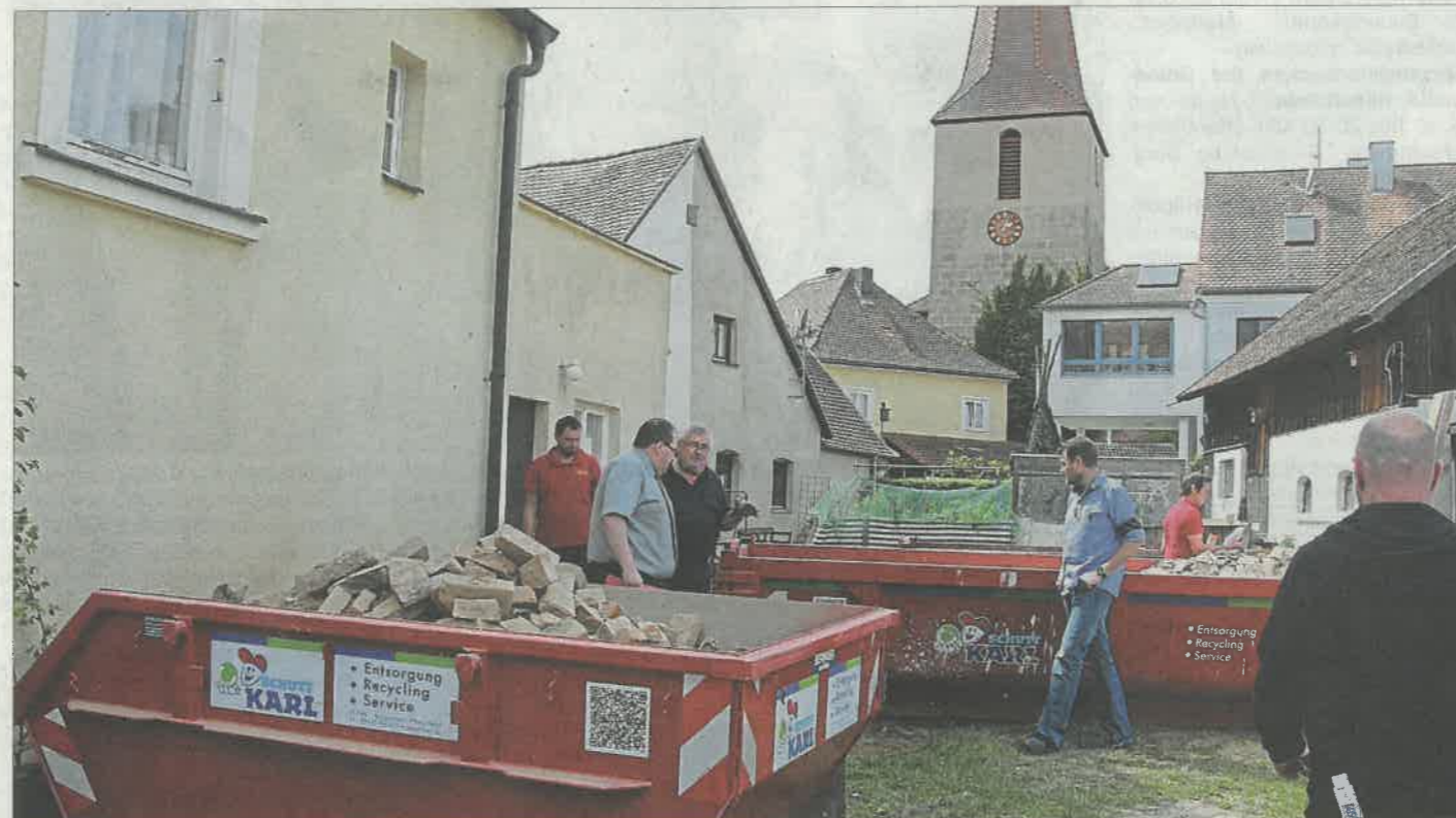
Von außen ist noch nicht viel vom Umbau und der Umgestaltung des ehemaligen Bauer-Anwesens zu einem Haus des Buches zu sehen. Nur die Container mit Bauschutt zeigen, dass hier mit Hochdruck gearbeitet wird. Fotos: Karch
