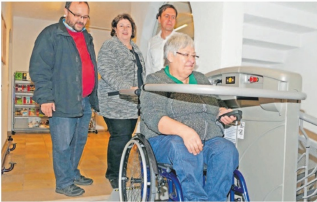
Test bestanden: Wenn der Gemeinderat im ersten Stock des Rathauses tagt, können in Zukunft auch Rollstuhlfahrer zuhören. Der neue Lift macht es möglich. Foto: Heckel
